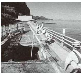
(例) 道路陥没の様子
