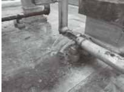
宅地内漏水の様子
