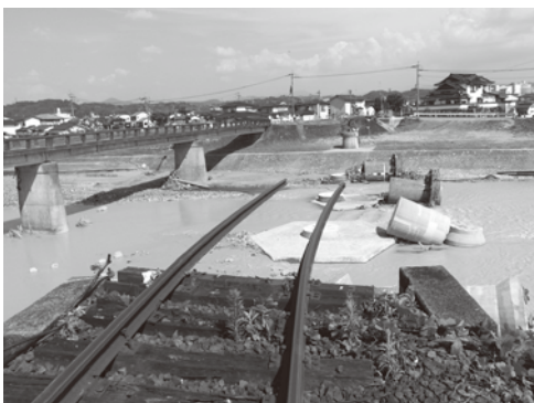
▲豪雨で流された鉄橋
