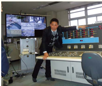
筑後川取水施設【操作室】(久留米市) 主要施設は遠隔で監視運転されている。
