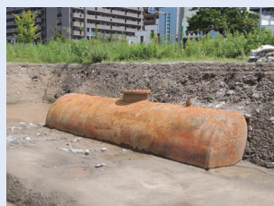
金属製タンク
