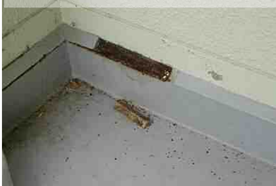
特別・普通・管理室棟／モルタル剥落
