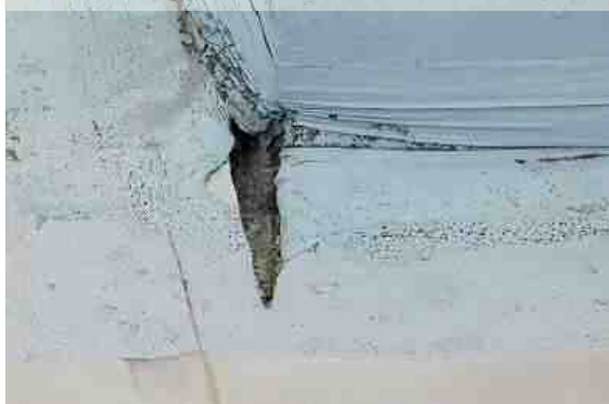
管理普通特別教室棟／防水シートの剥がれ
