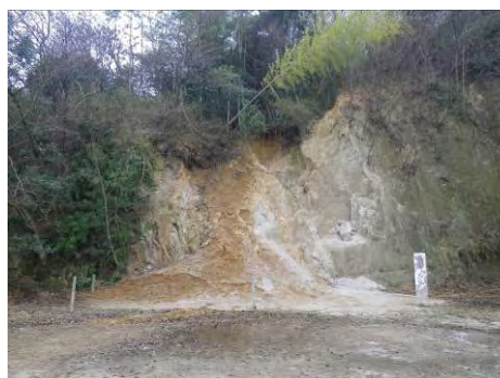
楔形の崩壊地
