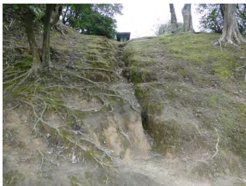
のり面に生じた小規模なガリー浸食
