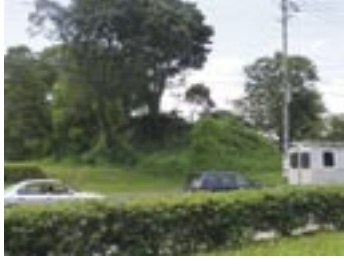
県) 福岡日田線沿道の崩落した土塁。
