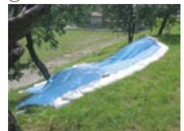
近年の大雨で崩落したテラス。
