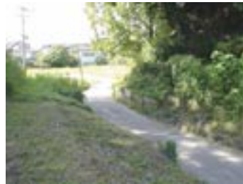
西門跡の生活道路、矢板により土塁の崩落が押さえられてる。
