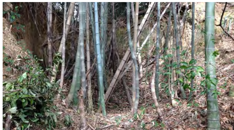
図 8-1: 東門跡周辺の土塁き損部
