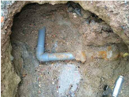
水道管の漏水
