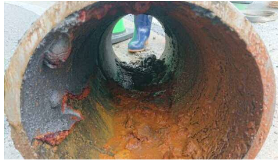
老朽化した水道管の内部
