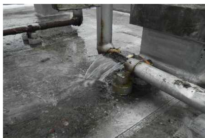
給水管からの漏水
