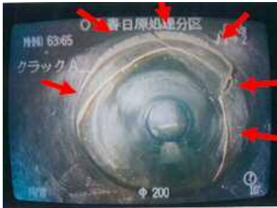
汚水管内の破損状況
