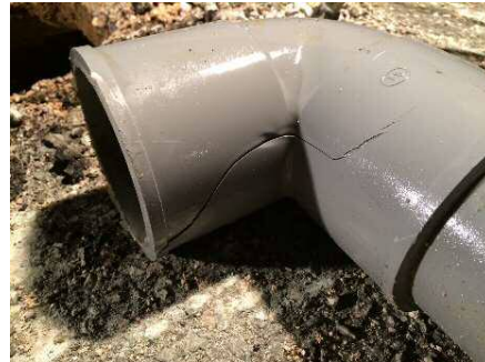
漏水原因箇所
