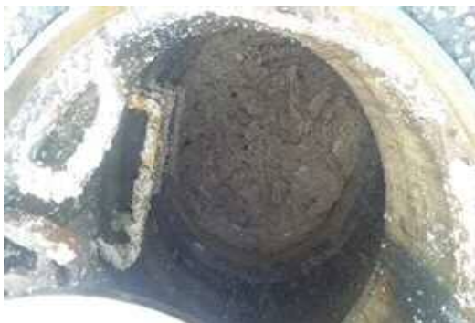
油脂によるマンホール内の閉塞
