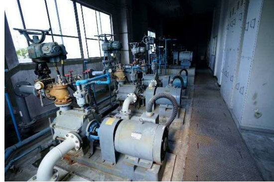
瓦田浄水場の老朽化施設
