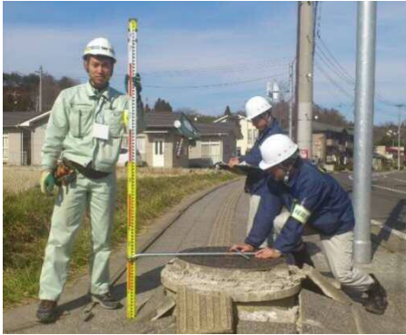
マンホール浮上状況
